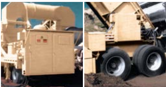
Главная силовая панель расположена на платформе рукавного пылеуловителя, а распределительная коробка управления установлена на конце рамы с унтером отгрузки и кабиной управления.
